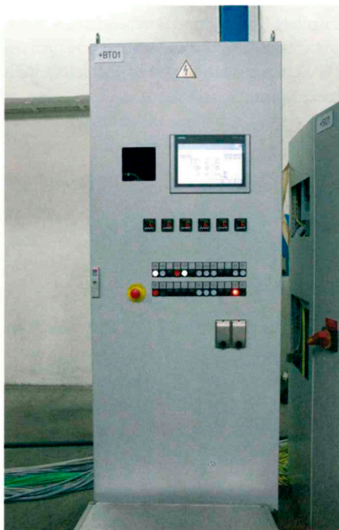
Abb. 9: Elektrische Anlage mit Bedienschrank
