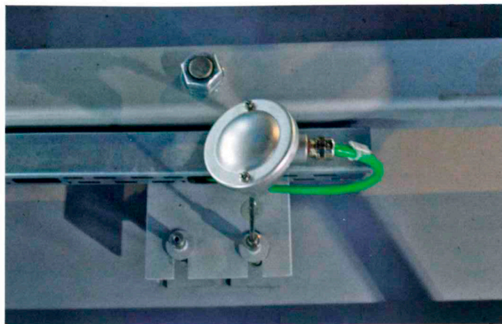
Abb. 8: Thermoelement zur Temperaturerfassung und Regelung mit Prüf-stelle entsprechend AMS 2750
