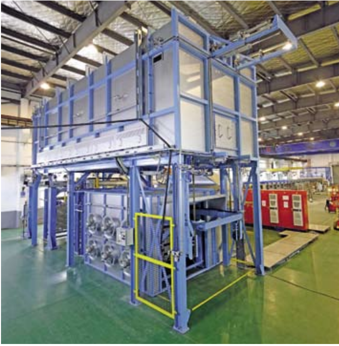
Abb. 2: Warmauslagerungsanlage mit Luftkühleinrichtung und elektrischer Anlage, fertig montiert / Fig. 2: Artificial ageing system with air cooling zone and electrical equipment, shown fully assembled
